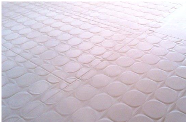
Bild 14 Einlagig vergossen mit leichten Unebenheiten durch Materialschrumpfung
